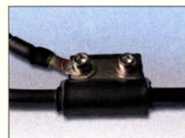
Detailansicht einer Erdungsschelle
